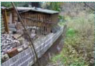
Private Befestigung des Ufers „Marke Eigenbau“, naturfern und bei Hochwasser sehr gefährlich (Foto: LPV Sächsische Schweiz-Osterzgebirge e.V.)
